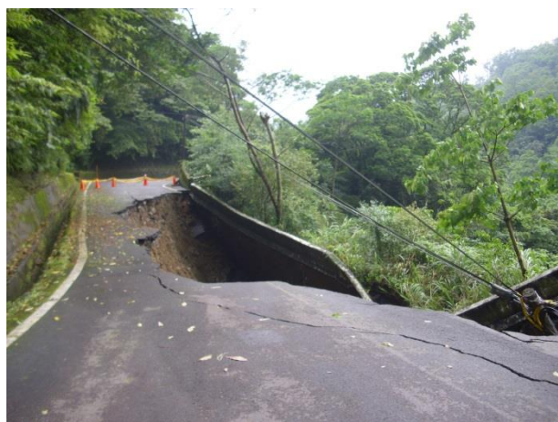
圖 11 平溪區望古里石灼坑道路 0602 豪雨災害搶修 復建 工程-災害情形
