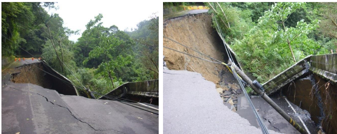
圖 2 平溪石灼坑 106 年 6 月初梅雨造成路基掏空道路重創道路中斷
