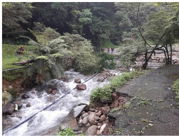
圖 9 金山區兩湖里兩湖分校旁野溪 0602 豪雨邊坡 災害復建工程-災害情形
