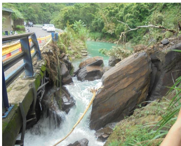
圖 13 新店區平廣路 125 之 1 號旁黑橋 0616 大雨搶 修復 建工程-災害情形
