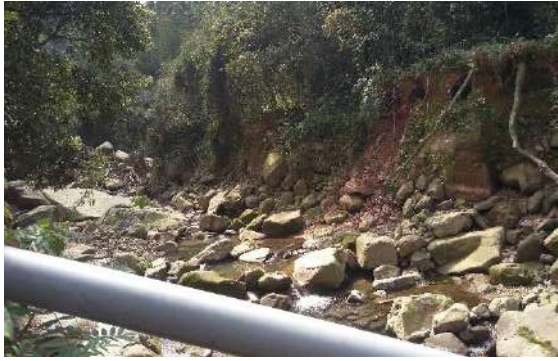
圖五 三峽區安坑里安坑 107 之 2 號旁及鹿母潭溪上游利奇馬颱風災害復建工程-災害情形
