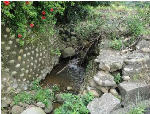
圖九 石門區山溪里九芎林溪支流米塔颱風災害復建工程-災害情形
